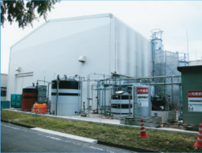
施設全景。ドームの外側には排水処理施設が設置されている
