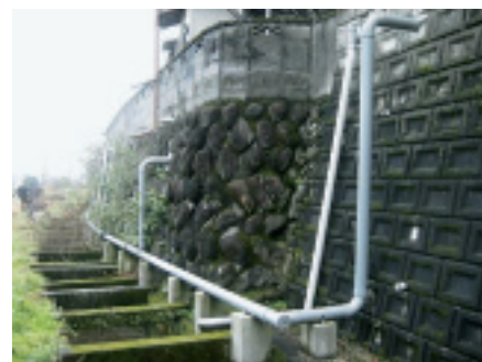
露出配管の配管例
