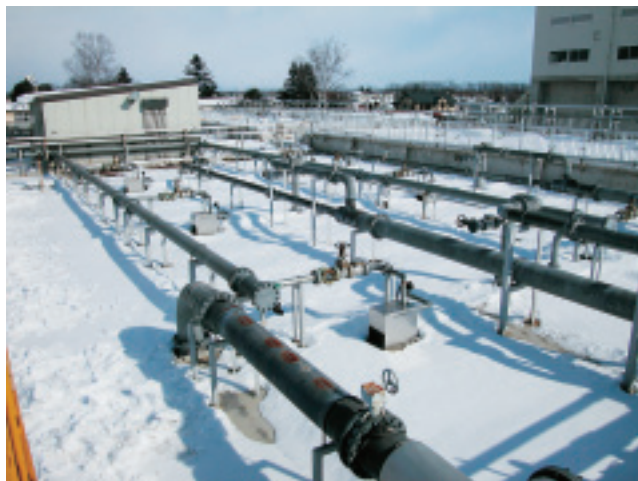
膜分離槽からの処理水を汲み上げる配管が並ぶ
