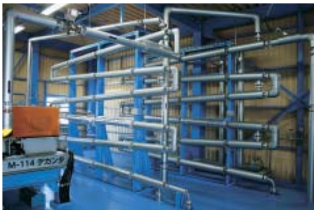
廃熱を回収し再利用している
