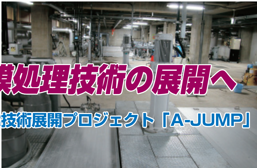
改築MBRの実証が行われている守山水処理センターの水処理施設
