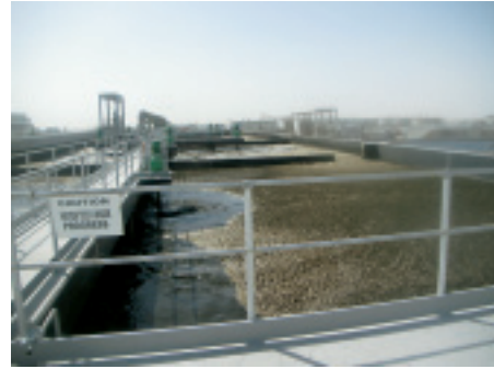
写－２ ドーハ西下水処理場総合試験運転状況
