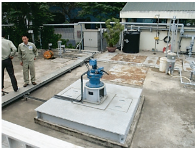
ハノイ市トゥック・バック下水処理場最終沈殿池
