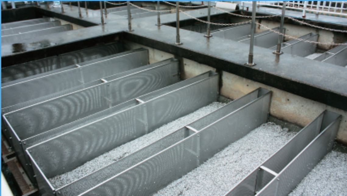
ろ過池内部（ろ過中）
