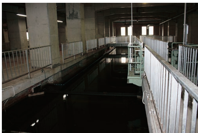
実機が設置された沈澱池
