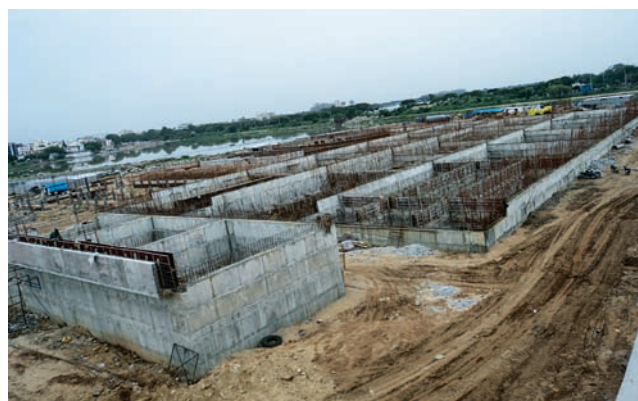
写－4 新設下水処理場（3万 \text{m}^3 /日）、BNR＋砂ろ過
