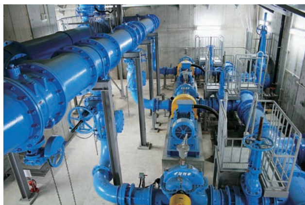
3 台の送水ポンプで再生水を供給
