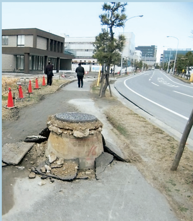
マンホールの浮上 (日の出1丁目付近)
