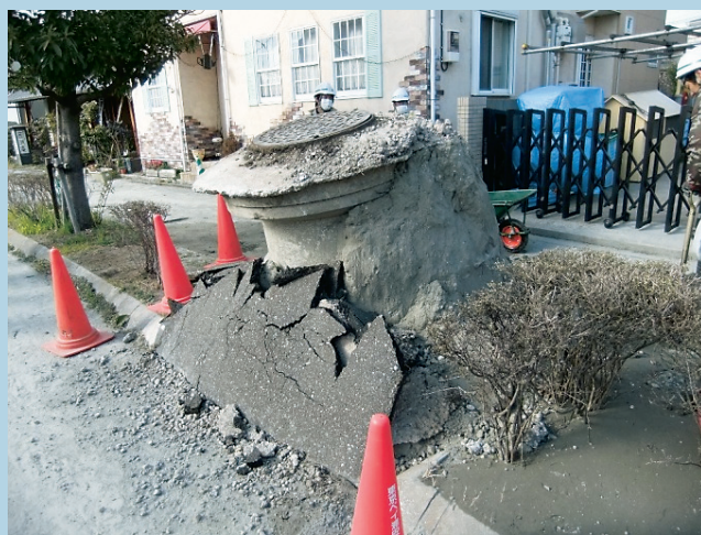
斜めに押し出されるように浮上したマンホール (高洲1丁目付近)
