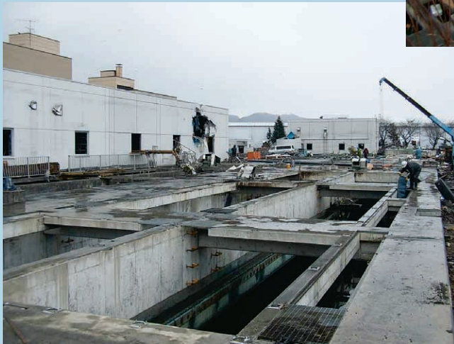
被災した最終沈殿地（大船渡浄化センター）
