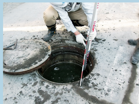
マンホール内の帯水 (舞浜3丁目付近)
