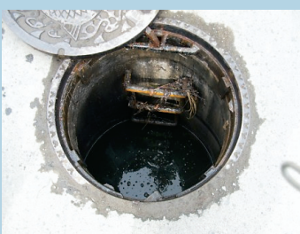
マンホール内状況から水位が急激に上昇したことがわかる（宮古市）
