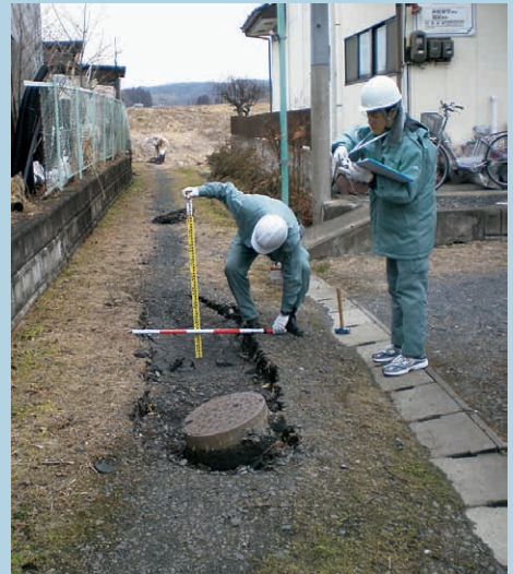
道路陥没やマンホールの浮上が見られた（一関市）
