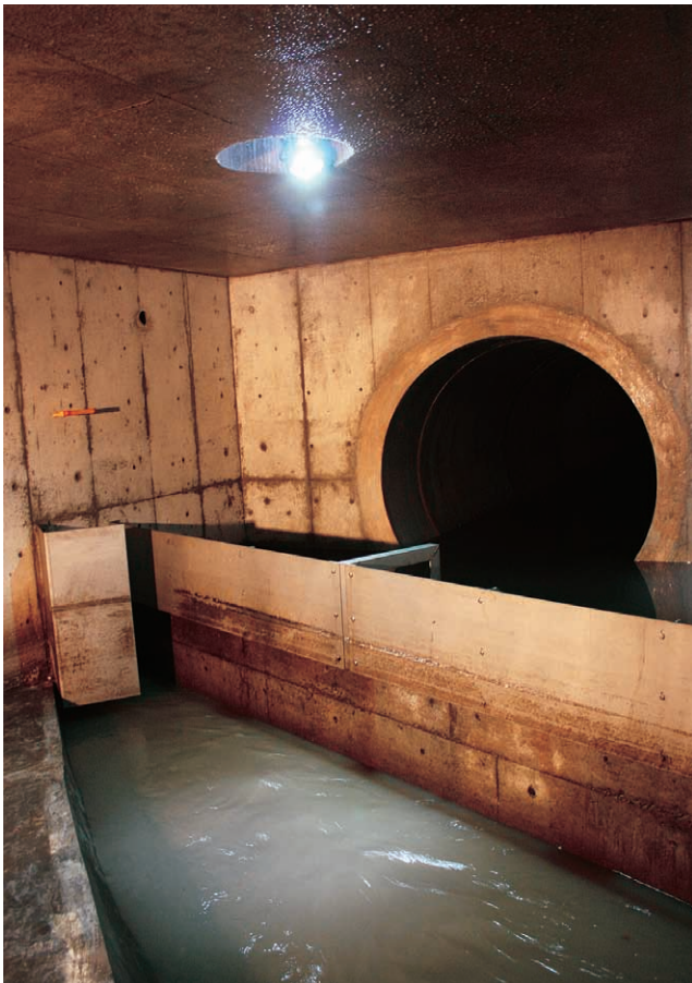
装置が設置された雨水吐室内部
