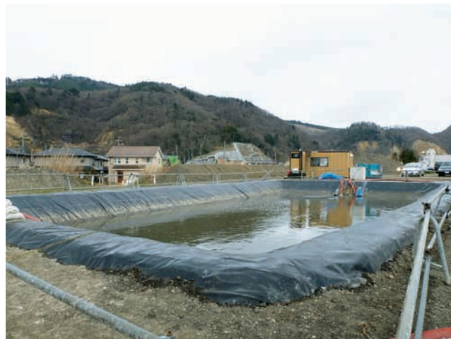
仮設沈殿＋消毒放流 (石巻第二汚水中継ポンプ場)
