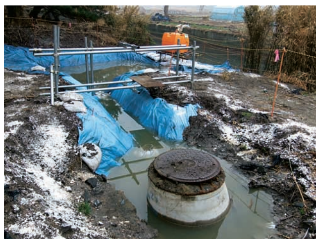
上流マンホール位置での沈殿＋消毒放流 (八戸汚水中継ポンプ場)
