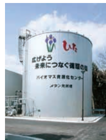
写真-2 銅板製消化タンクの例
