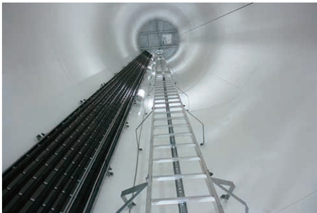
風車内部にはコードが走る
