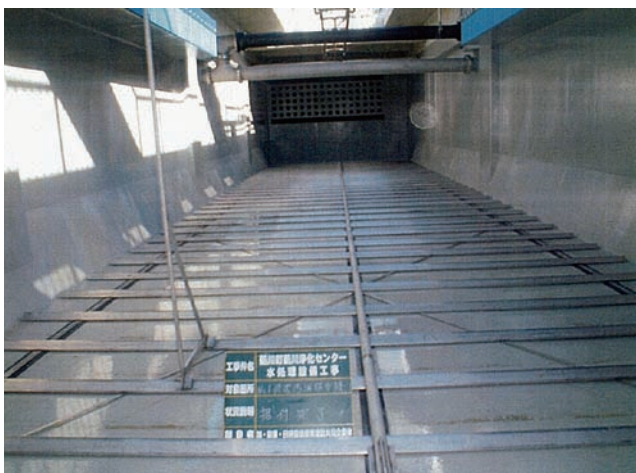
設置当初のレシプロ式汚泥かき寄せ機
