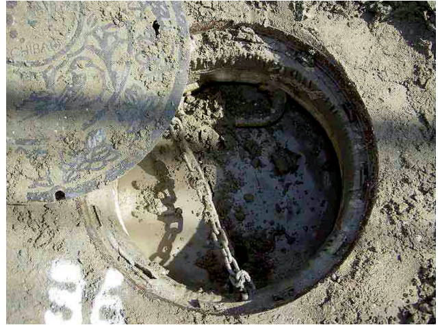
千葉市の人孔内の噴砂堆積状況
