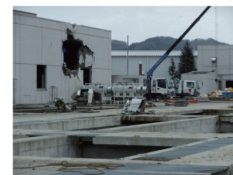
津波漂流物による被害
