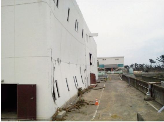
波力による被害状況
