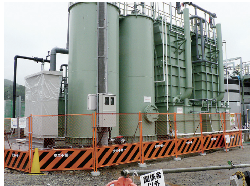
鹿折（浜町）に設置された仮設処理施設
