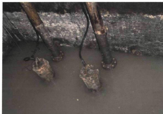
写真-1 既存ポンプ
