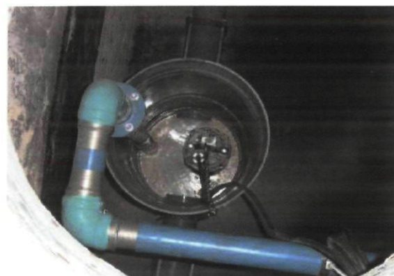
写真-2 新設ポンプとバレル
