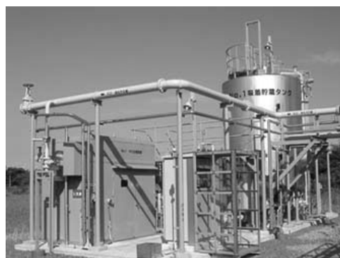
図-1 実設備外観
