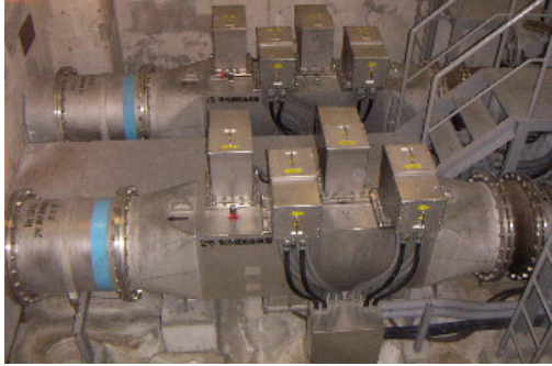
写真-1 密閉流通型紫外線消毒設備
