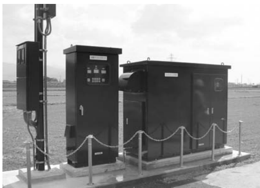
写真 - 1 空気注入設備の外観例
