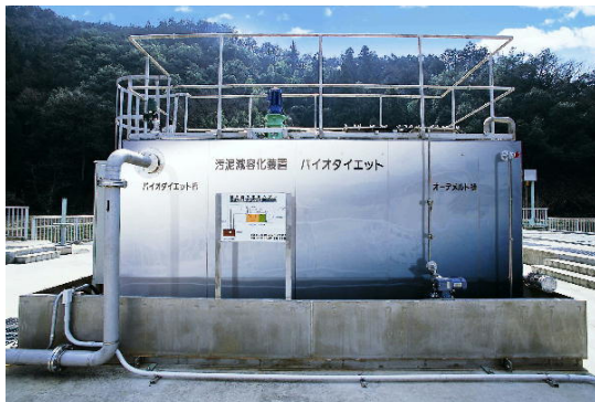
図 - 3 汚泥減量設備全景写真
