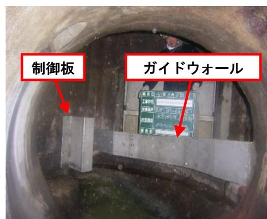
写真 - 1 水面制御装置の設置例
