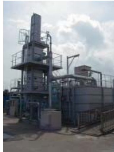
写真2 実証装置全景
