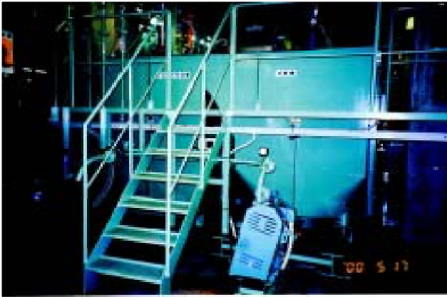
写真 - 1 パイロットプラント ( 大津浄化センター内設置 )
