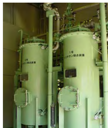
図1-5 シロキサン除去設備
