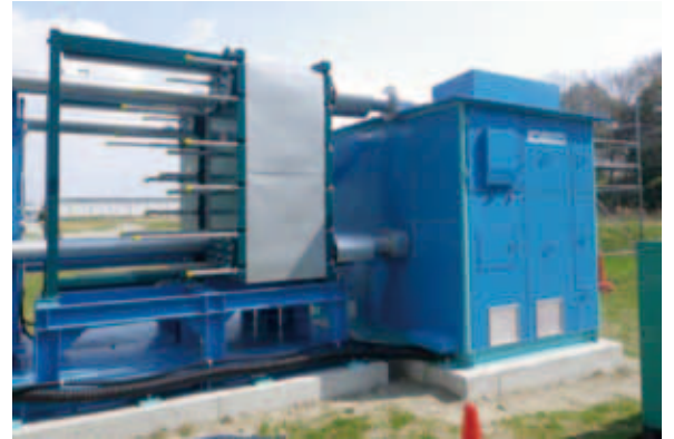
写真-1 バイナリー発電機外観
