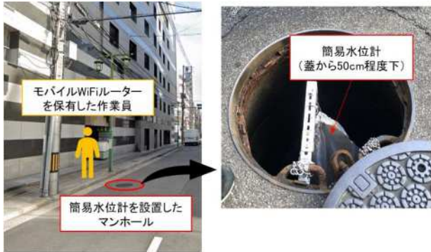
合流式のマンホール内に設置した簡易水位計の状況
